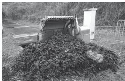
水路内の除塵機による作業
